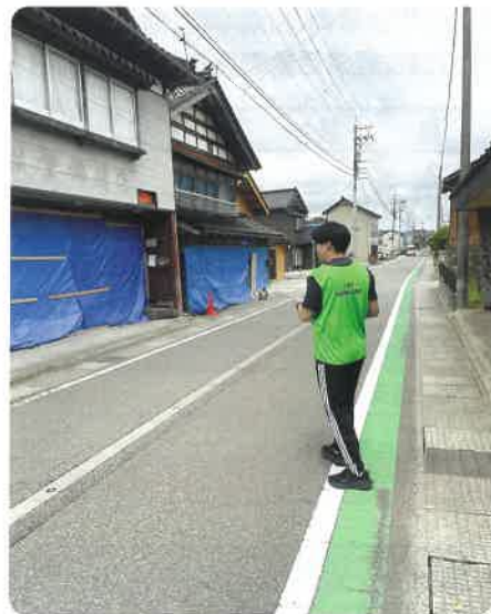
被災した家屋を現地調査
